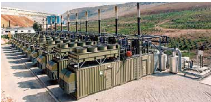
Άποψη εγκατάστασης 1ης φάσης- Έντεκα (11) container μηχανών DEUTZ TBG 620 V16 (2001).
